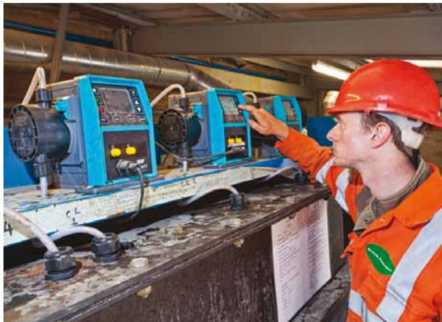
Applicazione delle pompe Qdos nello stabilimento Fluorspar LTD
