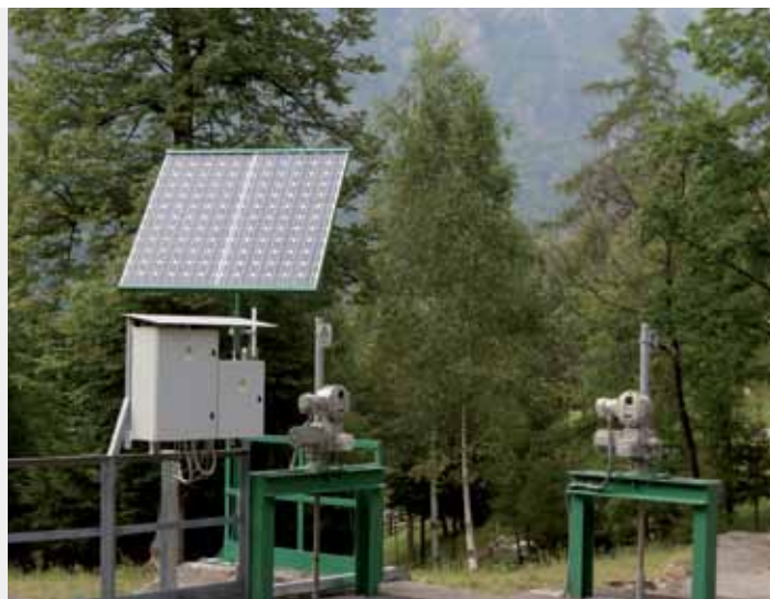
Attuatori per la motorizzazione e il telecontrollo di apparecchiature idrauliche alimentati con pannelli fotovoltaici
