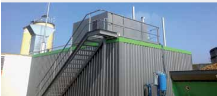
L'impianto di Genzone (PV)
