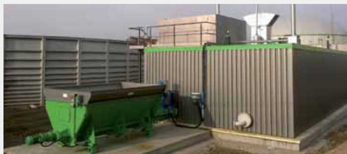
L'impianto di Genzone (PV)
