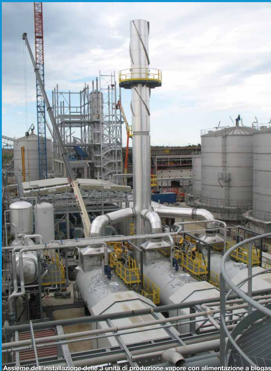
Assieme dell'installazione delle 3 unità di produzione vapore con alimentazione a biogas
