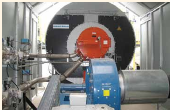
Particolare del bruciatore bi-fuel, idoneo per biogas
