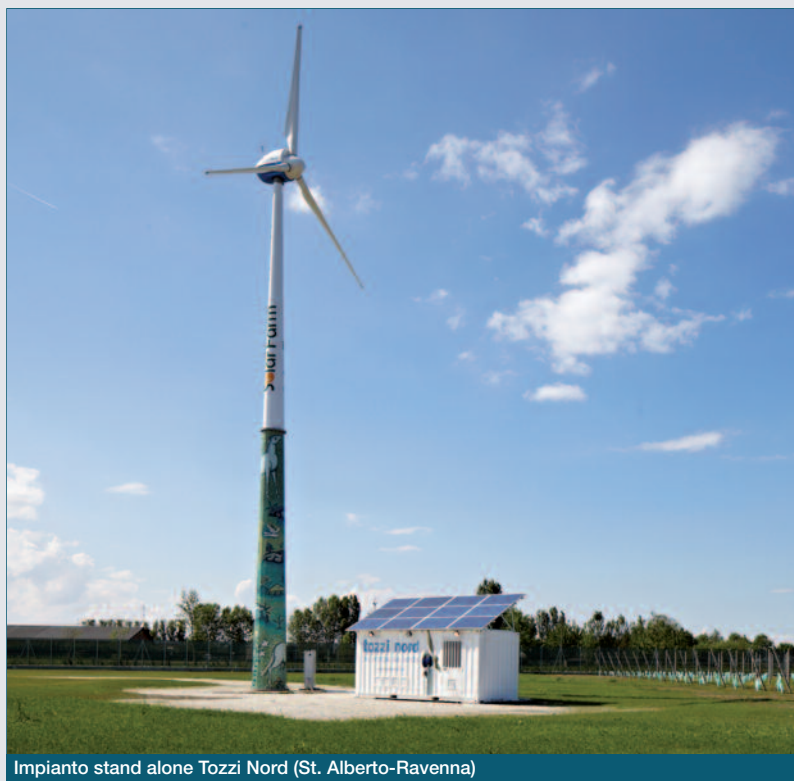
Impianto stand alone Tozzi Nord (St. Alberto-Ravenna)
