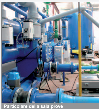
Particolare della sala prove
