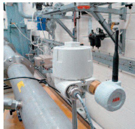
Adattatore installato sull'impianto
