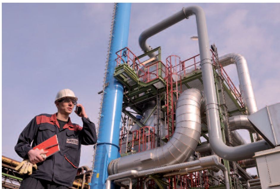
L'impianto di riduzione di ossido nitroso nello stabilimento di Krefeld-Uerdingen
