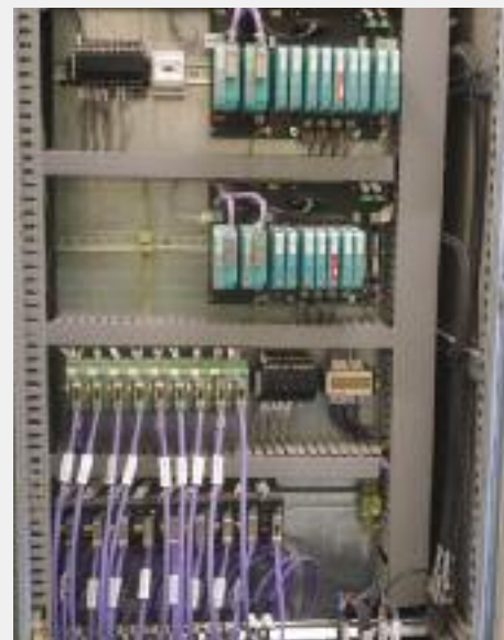
Armadio contenente due motherboard con Power HUB SK3 con gateway ridondante (verde), modulo ADM di Pepperl+Fuchs (rosso). Ben visibili le connessioni con cavo viola per comunicazioni in Profibus PA
