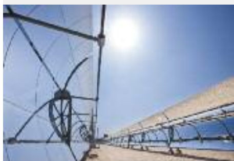
Particolare dell'impianto Archimede
