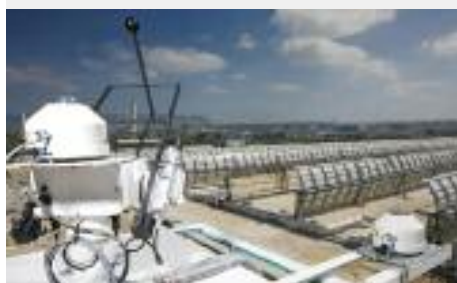
L'impianto solare a concentrazione Archimede a Priolo Gargallo (Siracusa)
