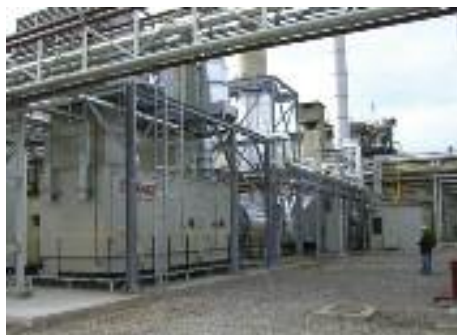
Vista d'insieme turbogas e caldaia recupero
