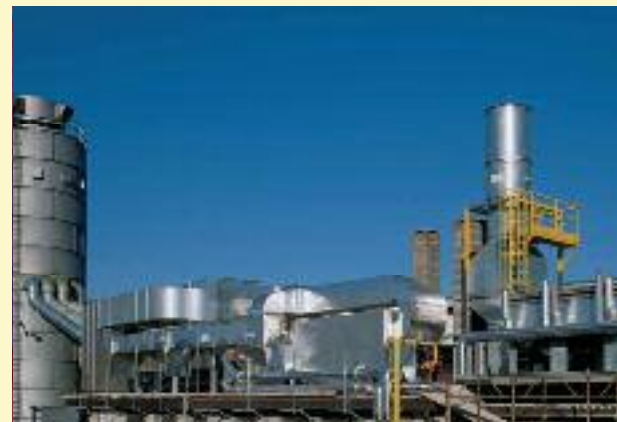
Impianto di abbattimento emissioni SOV con rigenerazione
