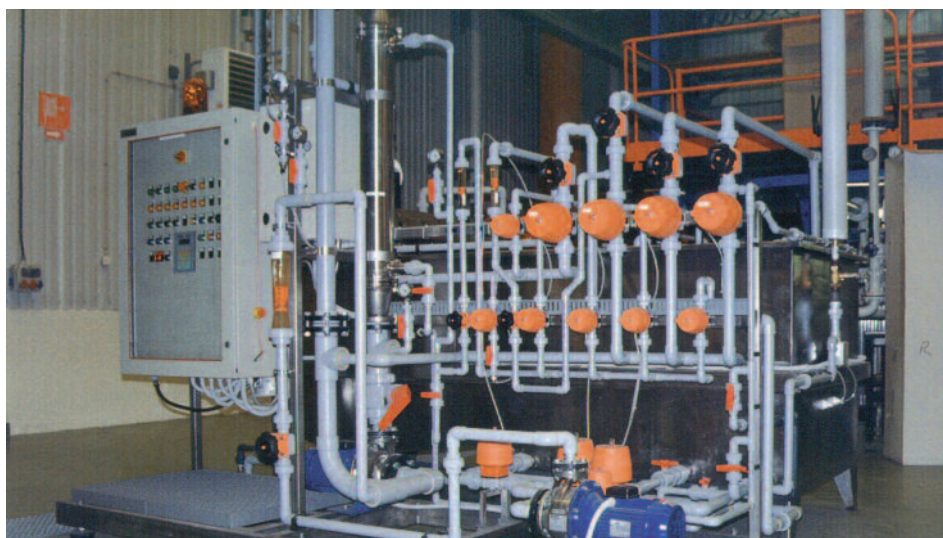
Impianto di ultrafiltrazione a membrane
