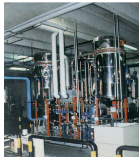
Impianto di evaporazione
