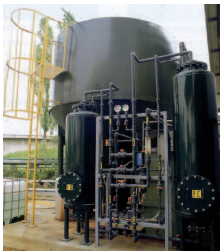
Impianto chimico-fisico per il trattamento degli scarichi
