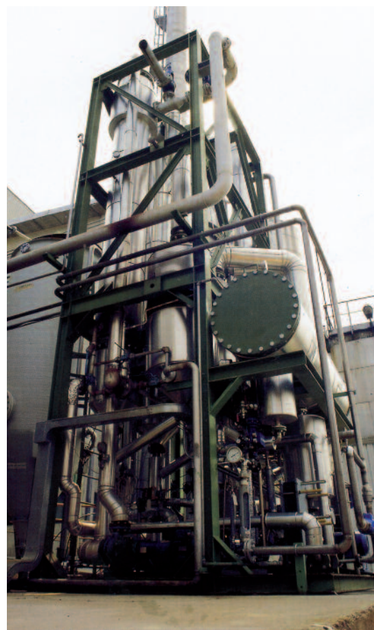
Impianto di evaporazione a triplice effetto
