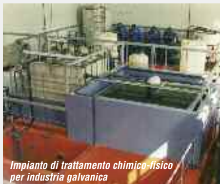
Impianto di trattamento chimico-fisico
