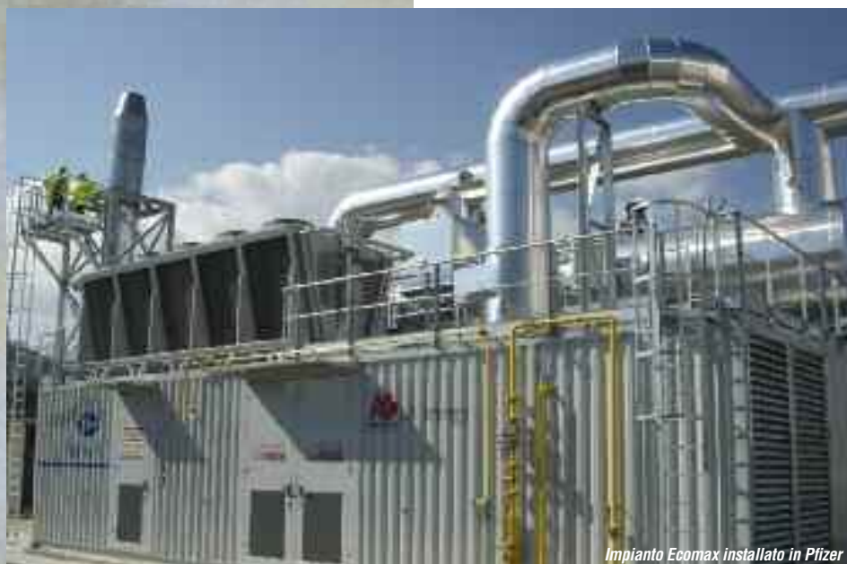
Impianto Ecomax installato in Pfizer
