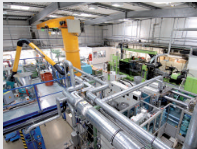
Particolare del technical Service Center di Dormagen
