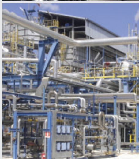
Due immagini dell'impianto Steam Methane Reformer di Priolo Gargallo (Siracusa)
