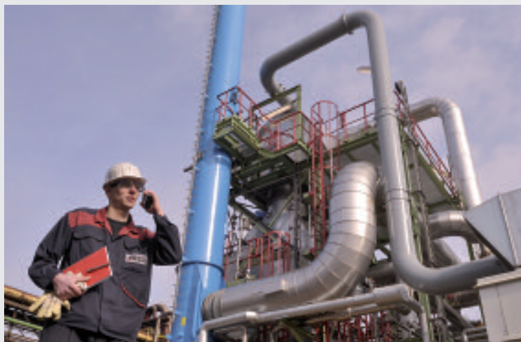
Un particolare dell'impianto di Krefeld-Verdingen
