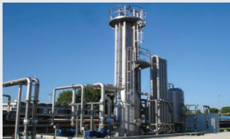
Impianto di depurazione
