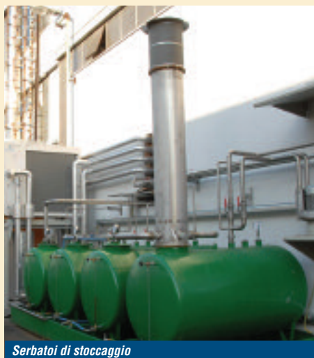
Serbatoi di stoccaggio
