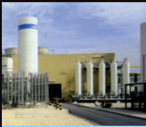
Linde - serbatoi di stoccaggio idrogeno
