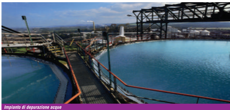
Impianto di depurazione acque
