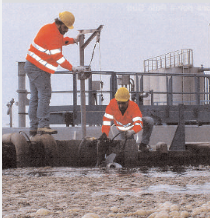
Installazione di un mixer in una vasca di equalizzazione depuratore per acque reflue provenienti da industrie chimiche e fognature civili
