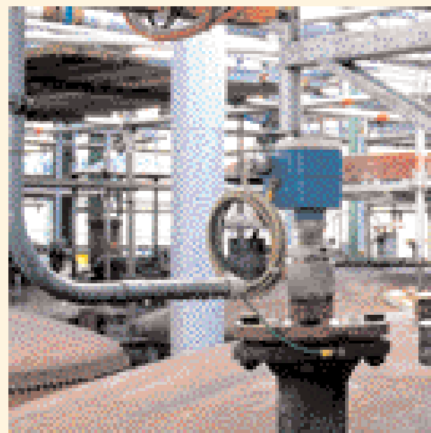
Un sistema di Plant Asset Management può ridurre del 30% i costi associati ai processi manutentivi
