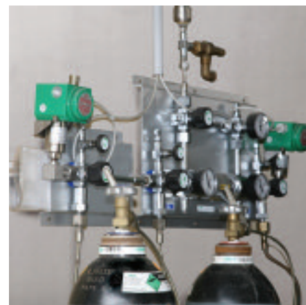
Box bombole laboratorio centrale
