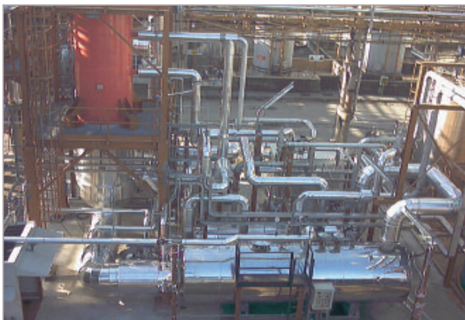
Impianto pilota industriale di decomposizione catalitica del protossido di azoto
