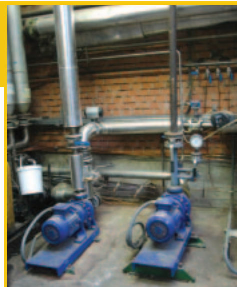
Pompe Iwaki, utilizzate per lo scarico di materie prime (ammoniaca soluzione e fenolo)
