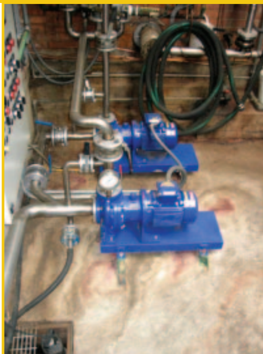
Sala pompe formaldeide: le due installate sono della serie MDM a trascinamento magnetico, fornite da Iwaki
