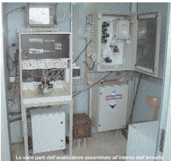
Le varie parti dell'analizzatore assemblate all'interno dell'armadio
