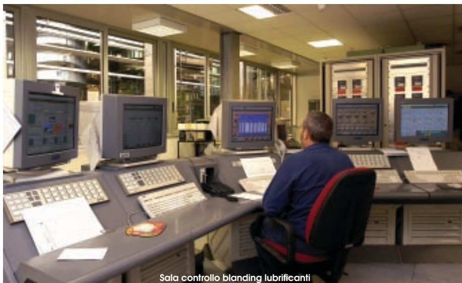
Sala controllo blanding lubrificanti
