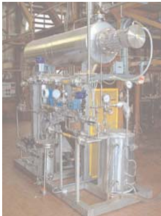
Impianto pre-pilota Radici Chimica
