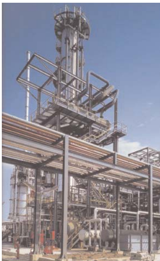
Particolare dell'impianto Viscolube di Pieve Fissiraga
