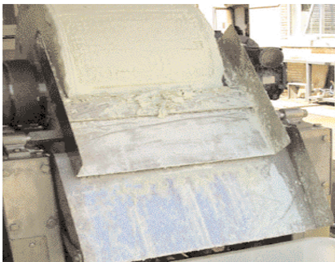
Figura 5 - Impianto skid mounted: separazione dello zolfo elementare
