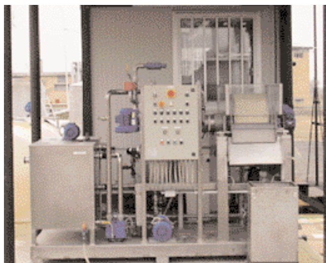
Figura 4 - Impianto skid mounted: sezione di separazione dello zolfo elementare
