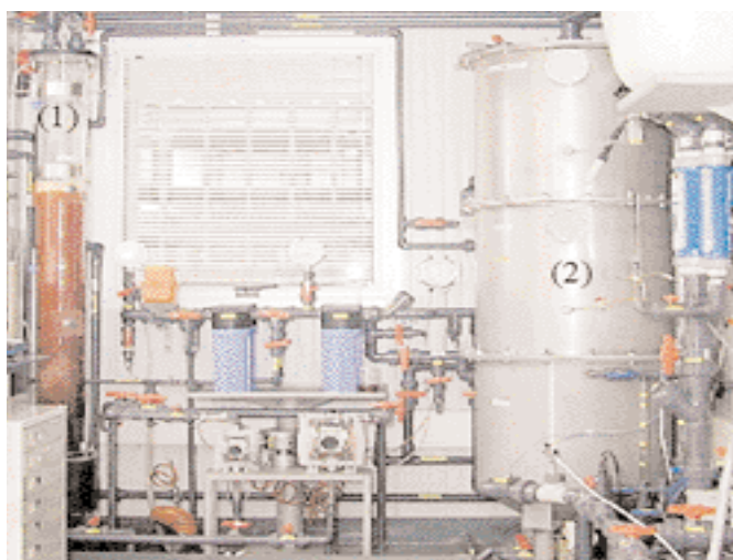
Figura 3 - Impianto skid mounted: 1) reattore (colonna a bolle) di assorbimento chimico; 2) reattore (trickle bed) di ossidazione biologica
