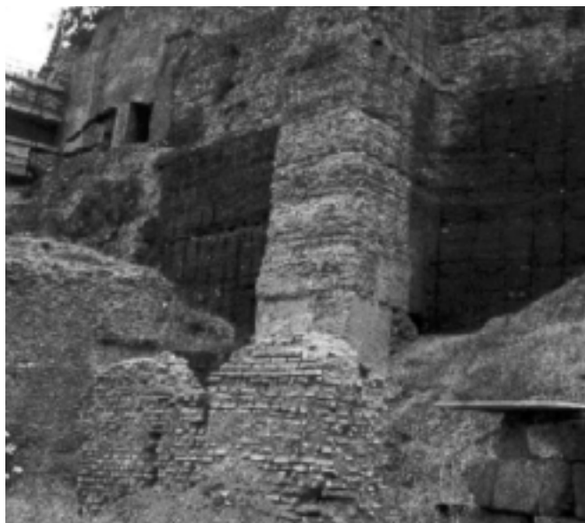
Figura 7 - Il muro di Figura 6 nello stato attuale. La porzione scura è impregnata di acqua
