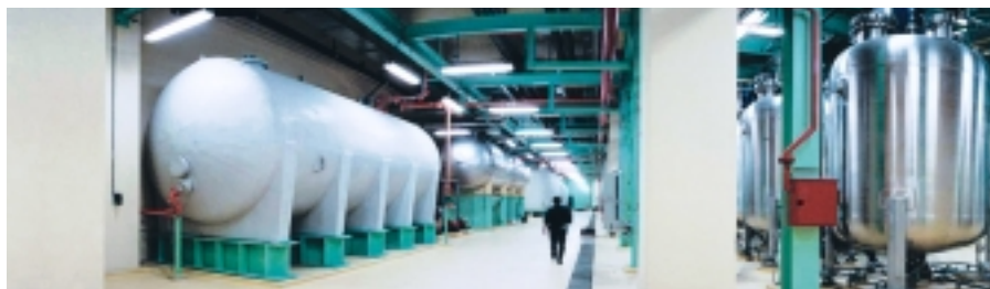
Uno dei reparti di produzione dello stabilimento Spin
