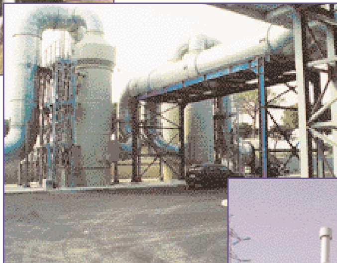
Figura 3 - Impianto di trattamento e deodorizzazione aria proveniente da linea di lavorazione Rsu e Cdr
