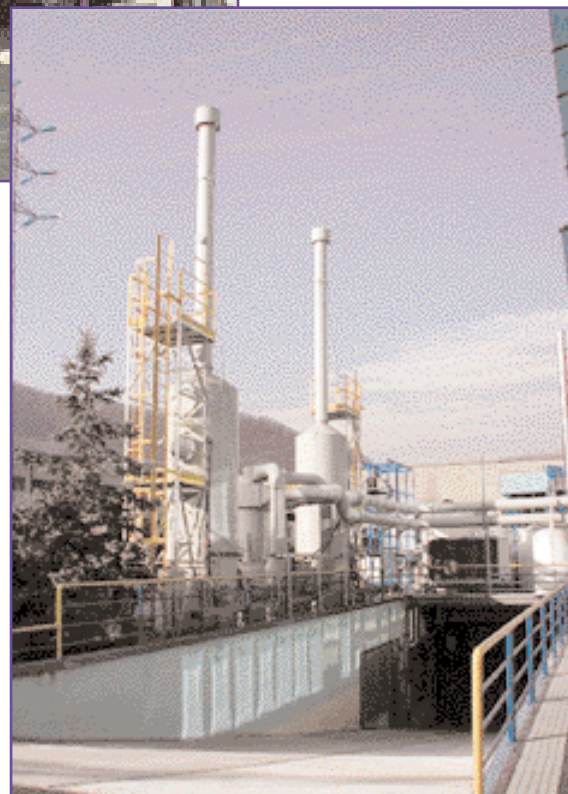
Figura 2 - Impianto di abbattimento fumi con scrubber-Venturi
