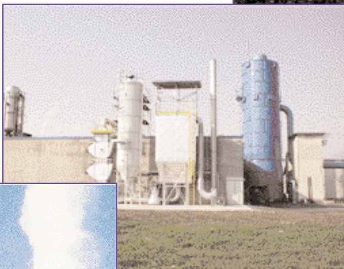
Figura 4 - Aspirazione e depolverizzazione fumi prodotti da biomassa lignea
