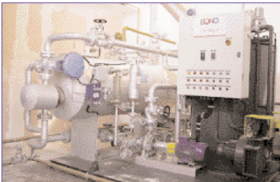
Figura 2 - La centrale termica
